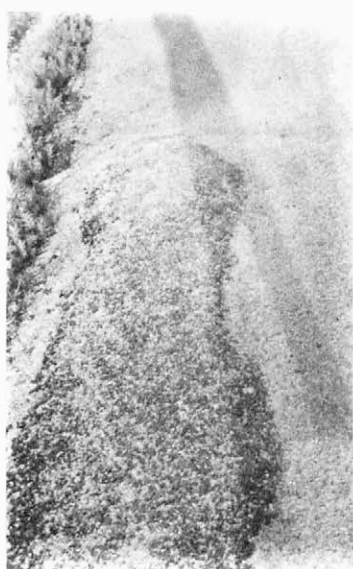
Τμήμα του δρόμου Λειβαδίου - Καλάμου. Παρά το γεγονός ότι ο φακός μας «έπιασε» τα μπαλώματα, η ποιότητα κατασκευής είναι γενικά ικανοποιητική.
