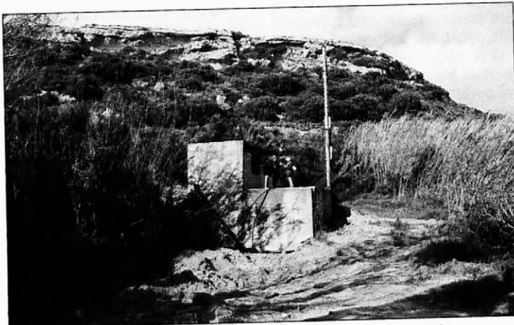
Οι εγκαταστάσεις υδρομάστευσης στη θέση Γωνία.
